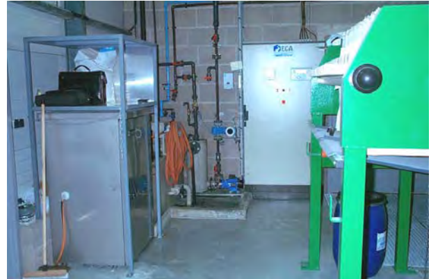
Relevage - Contrôle commande
